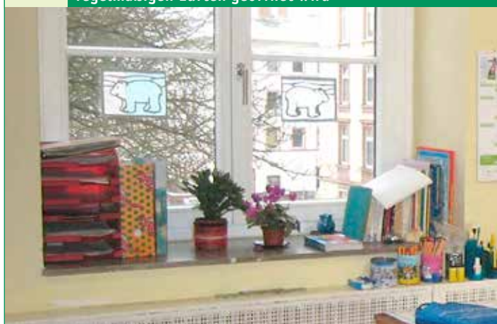
Abb. 2 Beispiel eines Fensters, das sicher nicht zum regelmäßigen Lüften geöffnet wird
